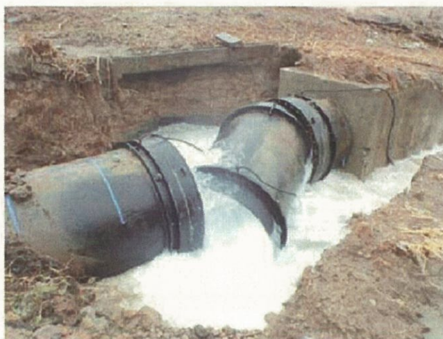
資料：東日本大震災水道施設被害状況調査最終報告書（厚生労働省）
