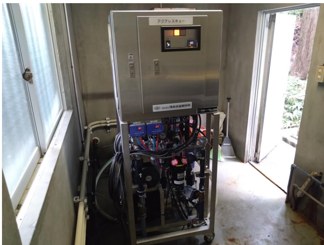
中岫地区中岫浄水場(可搬式膜ろ過装置)
