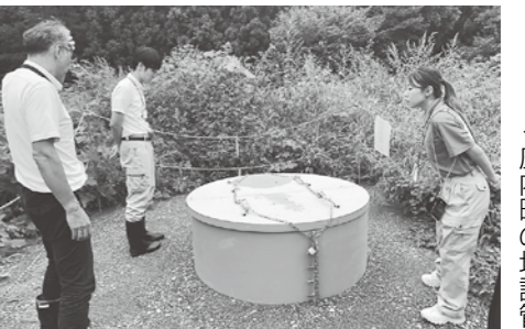
▶庄内町の埋設管
