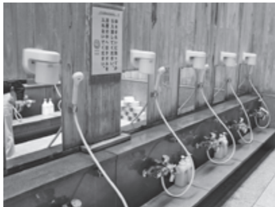
▲傷みの目立つ浴室内
