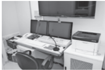
▶ 役場内の防災行政無線室
