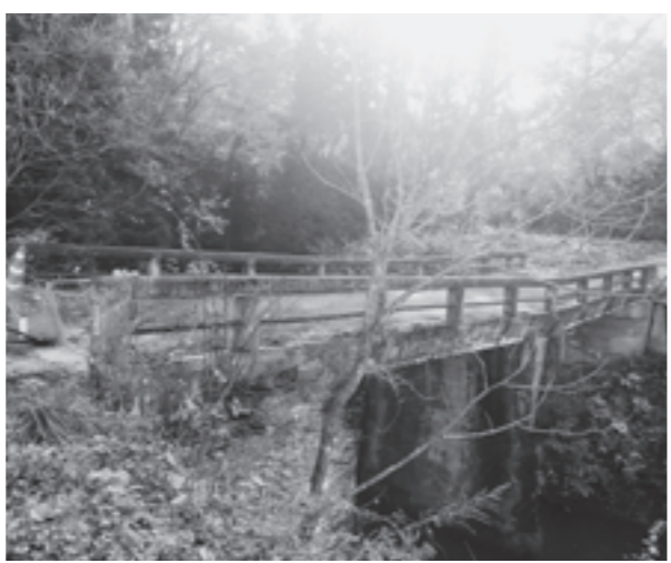
▲ 通行不能な大入間川橋
