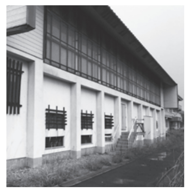
▲ 放置され傷み始めている体育館
