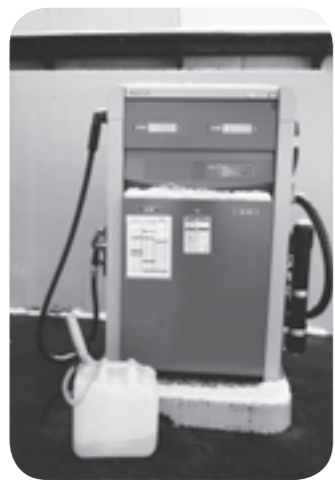
▶灯油計量器からの給油
