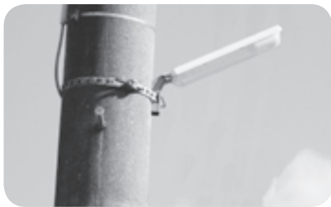
▲下堀地区のLED化になった防犯灯
